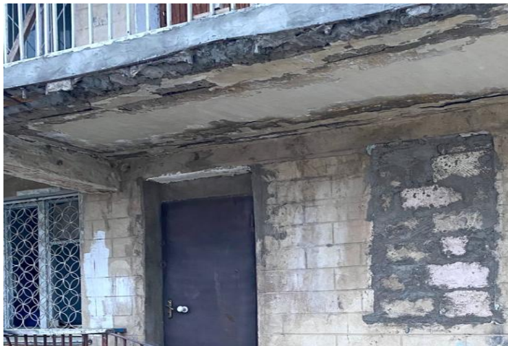
Сурет 2. Балкон плитасының қорғаныс бетон қабатының бұзылуы
