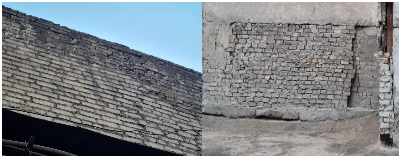
Сурет 1. Ылғалдың әсерінен ғимараттардың қоршау конструкцияларының кірпіш қалауының жергілікті апаттық учаскелері, кірпіш фрагменттерінің құлауы
